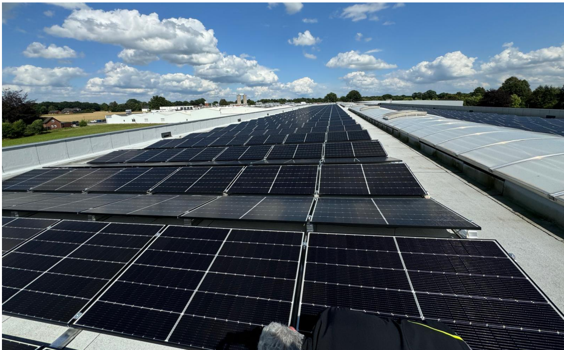
Solaranlage in Rietberg, geplant und errichtet von 4e gruenstromen GmbH
