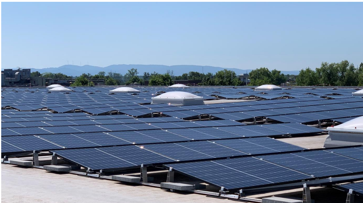
Solaranlage in Willstätt, geplant und errichtet von 4e gruenstromen GmbH
